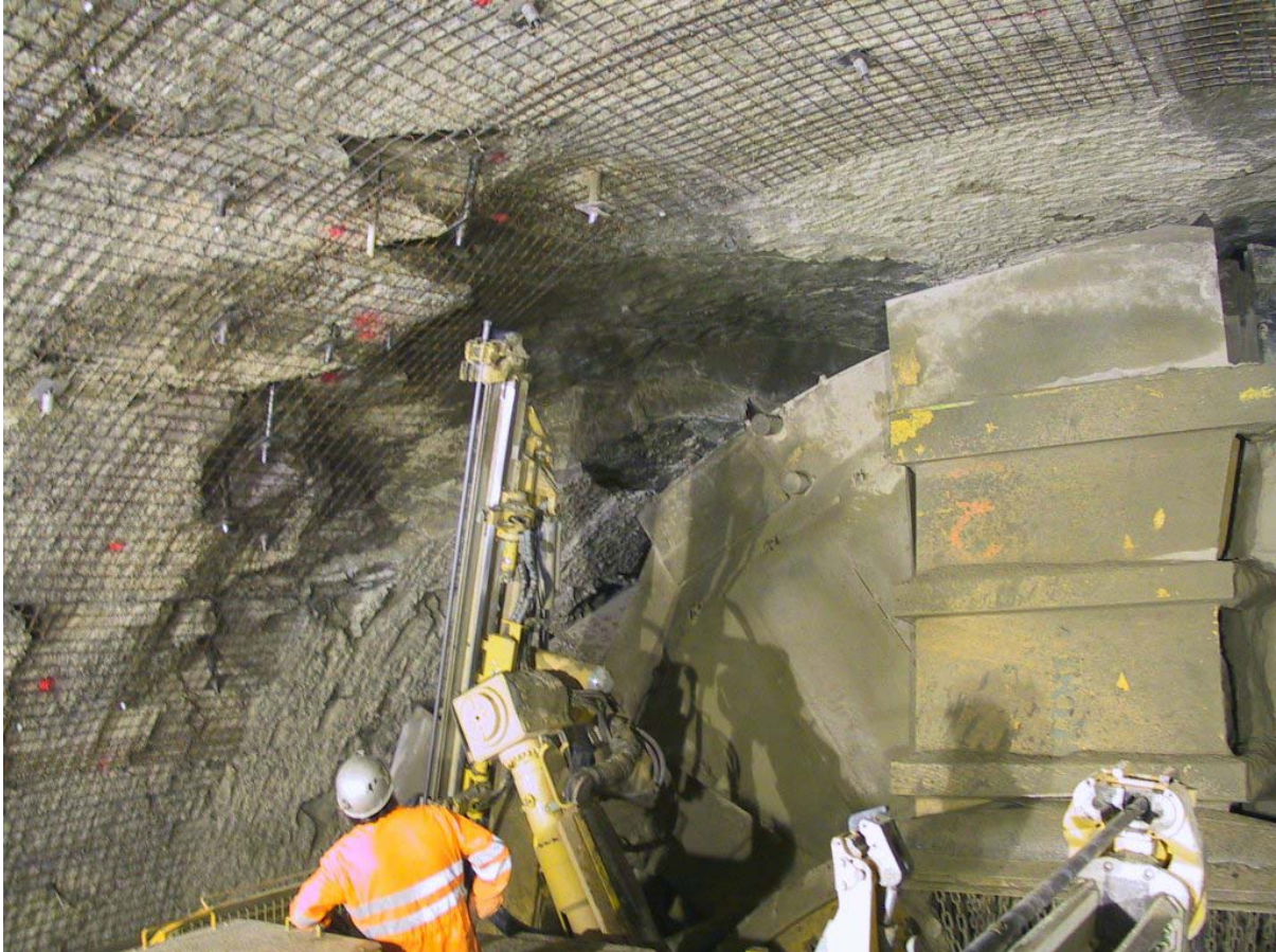
Bild 8: Ausbruchsicherung im L1 der TBE (mit Ablösungen unmittelbar hinter dem Schneidrad)
